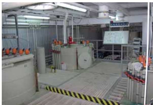
Rys. 2. Hala Oczyszczalni – instalacja do utylizacji odpadów chromowych Cr+6 i Cr+3
