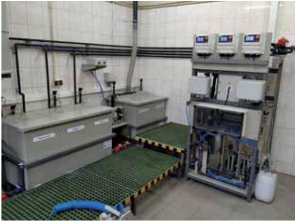
Rys. 7. Zbiorniki elektrodializera z instalacją sterująco-kontrolną
