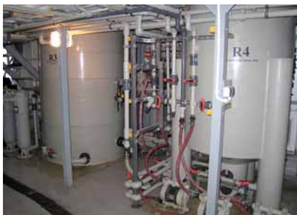
Rys. 1. Hala Oczyszczalni – instalacja do utylizacji odpadów i ścieków alkaliczno-kwaśnych
