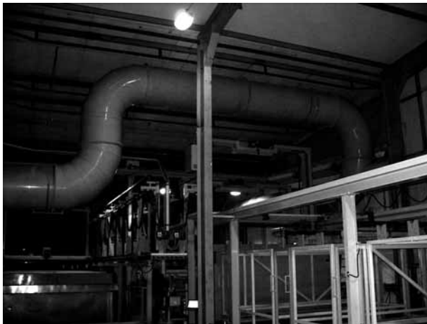
Ryc. 5. Rozbudowa linii automatycznej Ni-Cr w Protach Rypin. Rok 2009- automat zlokalizowany w zagłębieniu posadzki Natomiast część załadunkowo- rozładunkowa zlokalizowana na poziomie obsługi.
