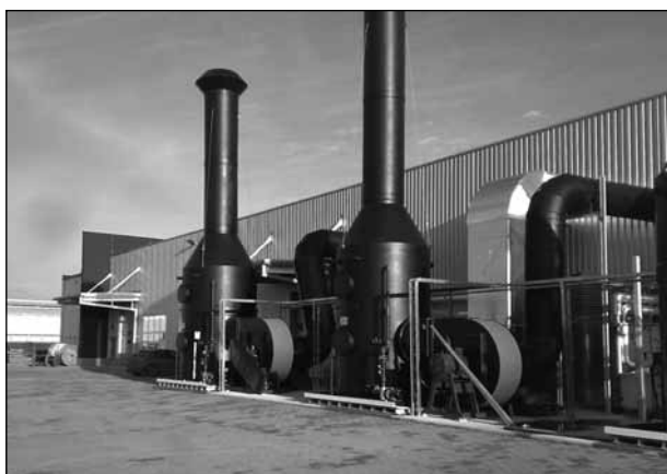
Ryc. 2. Neutralizator oparów galwanicznych zlokalizowany na zewnątrz nowo wybudowanej hali zakładu Heiche- Matusewicz
